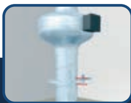
Frånluftsfläkt med irisspjäll
